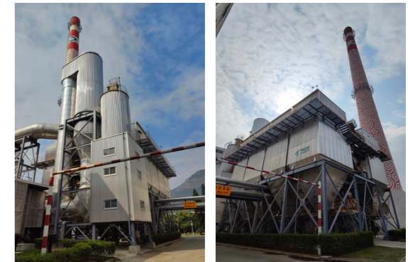
福清浮法脫硫脫硝除塵一體化設施
