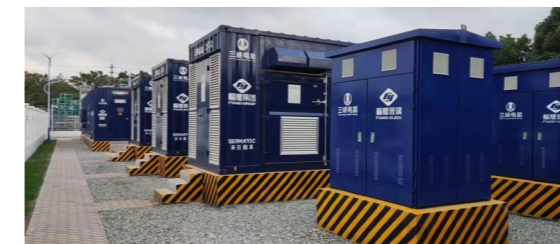
上海汽玻 7.5MW/22.5MWh 儲能項目
